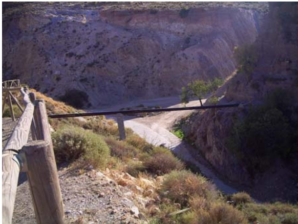
Tubería de la balsa (Punto 3 de la fig. 8) (Jorge Jiménez Sánchez)
