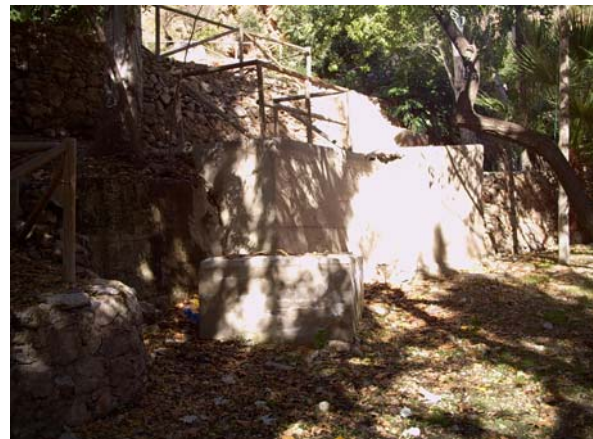
Derivación del caudal del cauce por medio de tubería (Puntos 12 y 13 de la fig. 8) (Jorge Jiménez Sánchez)
