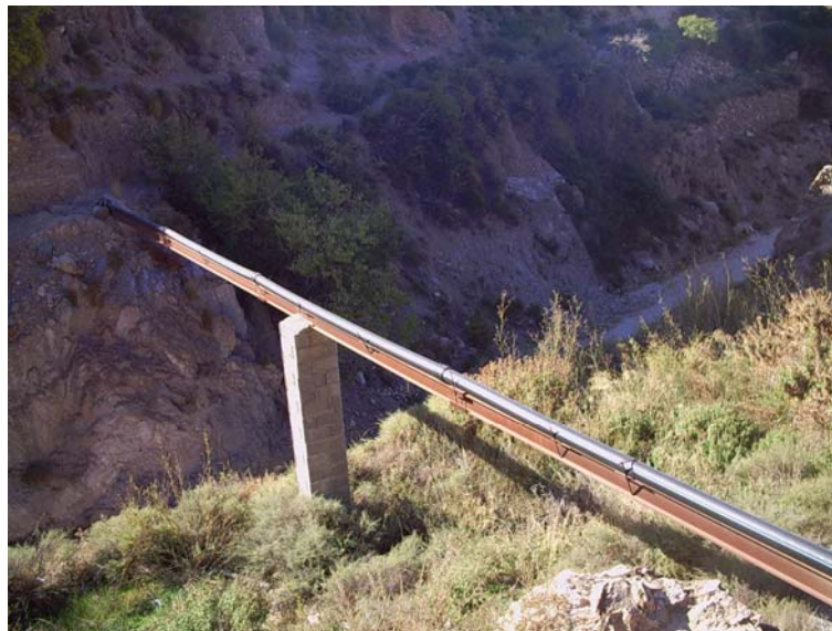
Tubería de la comunidad de regantes (Jorge Jiménez Sánchez)
